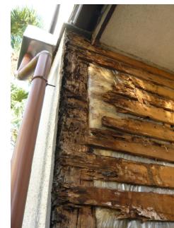
△ 屋根からの雨漏りで壁一面に腐食が広がった例。構造材まで痛んでいました。
