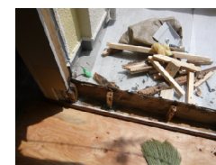
△ 窓枠からの雨漏りで引戸の下が腐った例。輸入住宅のため同じサッシが手に入らなくて国産メーカーのサッシを使用しました。
