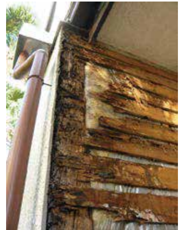
△ 屋根からの雨漏りで壁一面に腐食が広がった例。構造物材まで痛んでいました。
