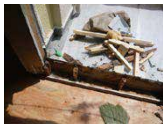
△ 窓枠からの雨漏りで引戸の下が腐った例。輸入住宅のため同じサッシが手に入らなくて国産メーカーのサッシを使いました。
